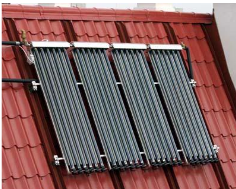
Obrázek č. 6 – Solární kolektory [7]
