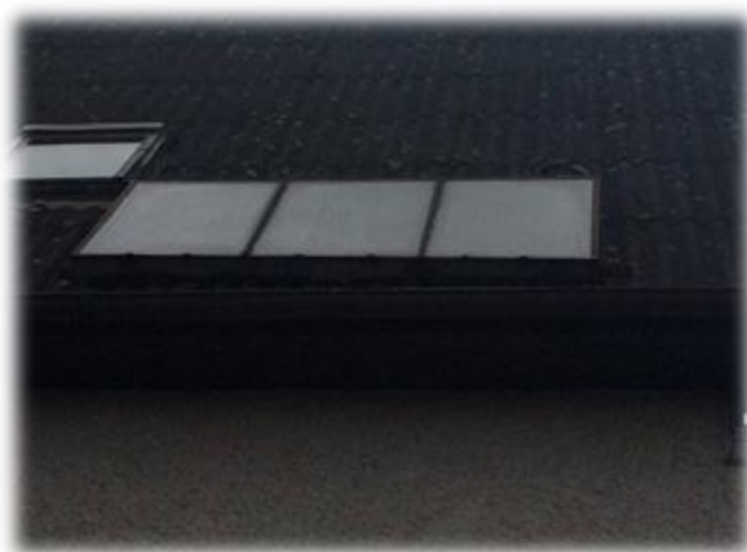
Obr. 5 a 6: Naše solární kolektory z.jihozápadu.
